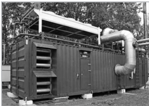
Когенерационная установка в г. Брест
