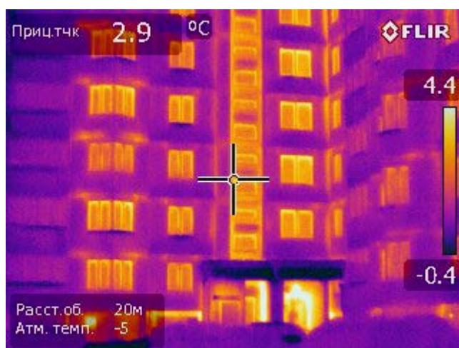
Рисунок 17 – Изображение участка фасада жилого здания в ИК-диапазоне
