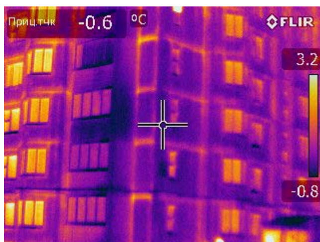
Рисунок 8 – Изображение участка фасада жилого здания в ИК-диапазоне
