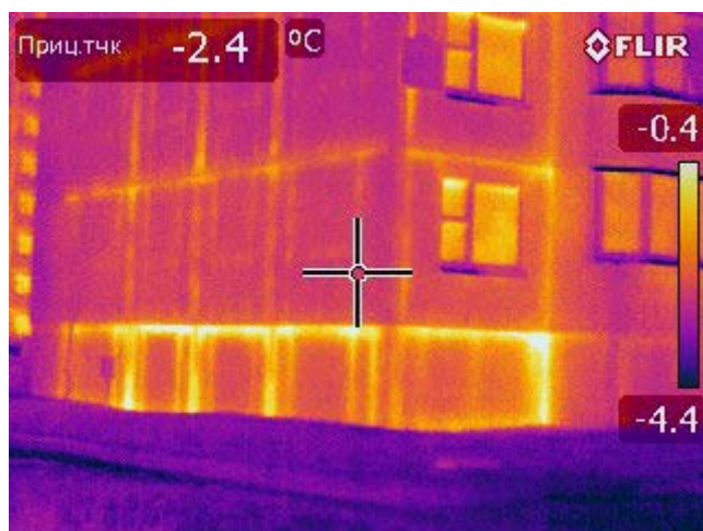
Рисунок 7 – Изображение участка фасада жилого здания в ИК-диапазоне
