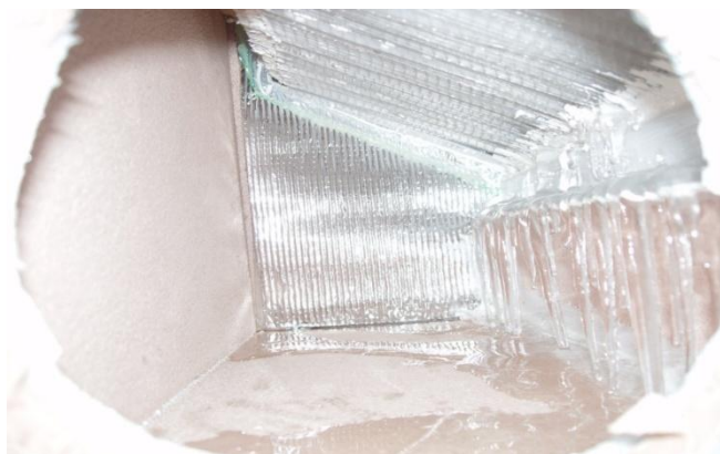
Рисунок 2.28 – Замерзший конденсат в камере удаляемого воздуха рекуперативного теплообменника
