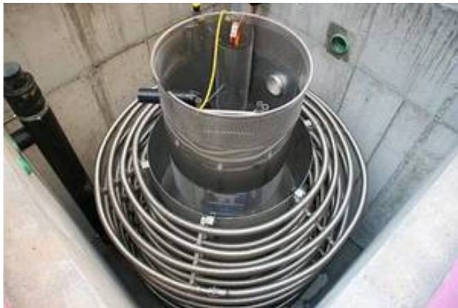
Фото 1: Вид на теплообменник-утилизатор перед обвязкой
