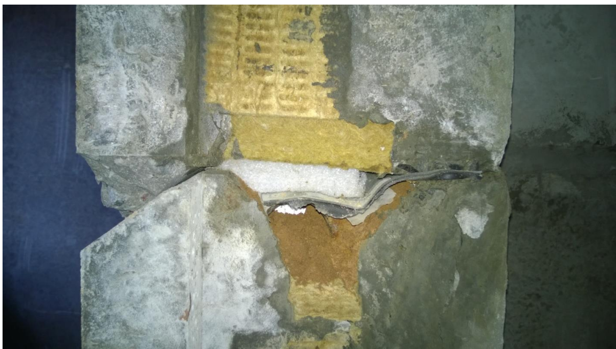
Рис. 8.1 Фотография стыка панелей здания с некачественным выполнением.
