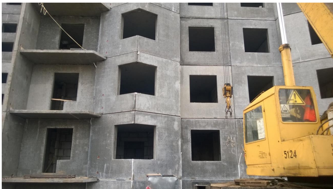
Рисунок 10 Проблемы стыков наружных стеновых панелей
