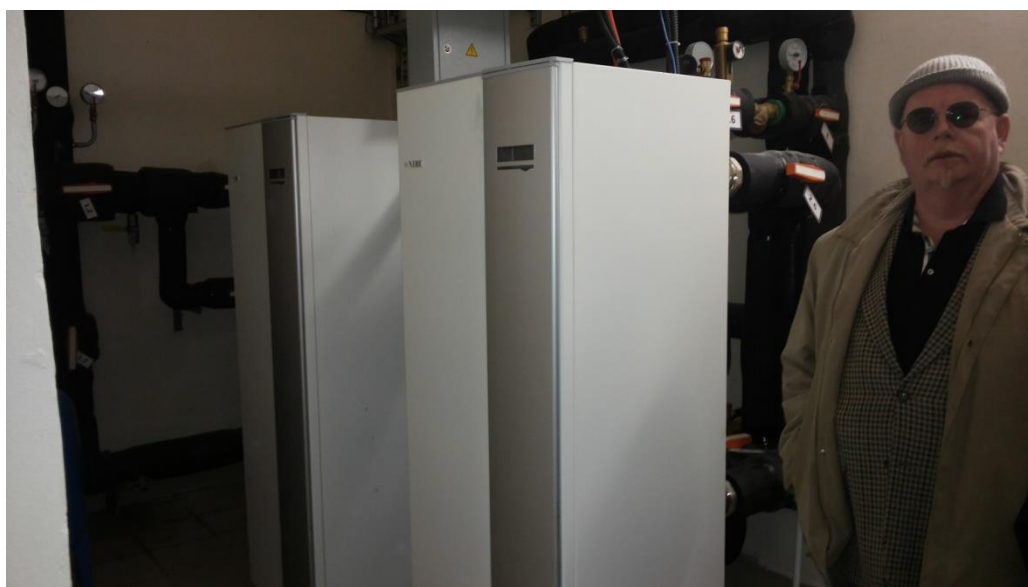
Рисунок 24 Фотография теплового насоса в тепловом пункте здания.
