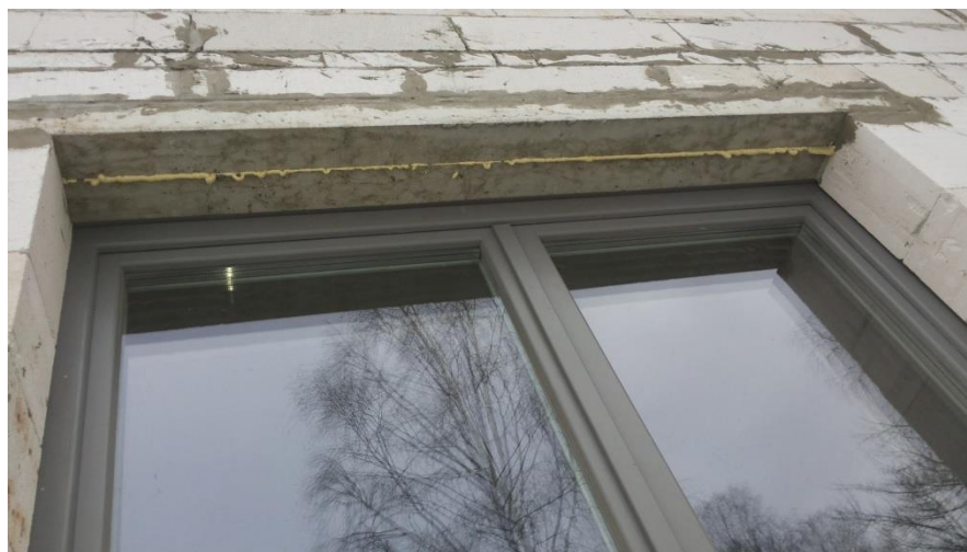
Рисунок 15- Перед уложенными ж/б перемычками отсутствует утеплитель
