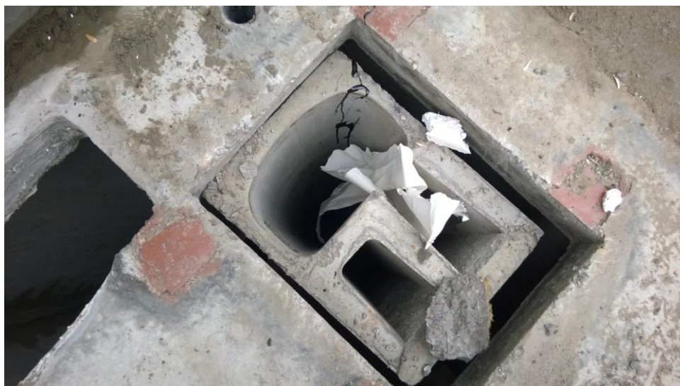
Рисунок 8.2 В вентиляционных шахтах – мусор,
