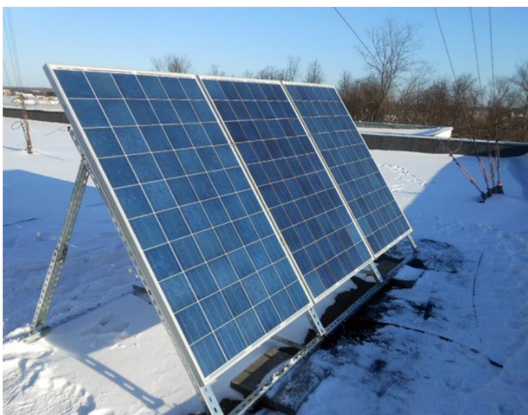
Рисунок 2.2 – Система автономного электроснабжения мощностью 750 Вт: центральная библиотека в Марьиной Горке, Пуховичский р-н
