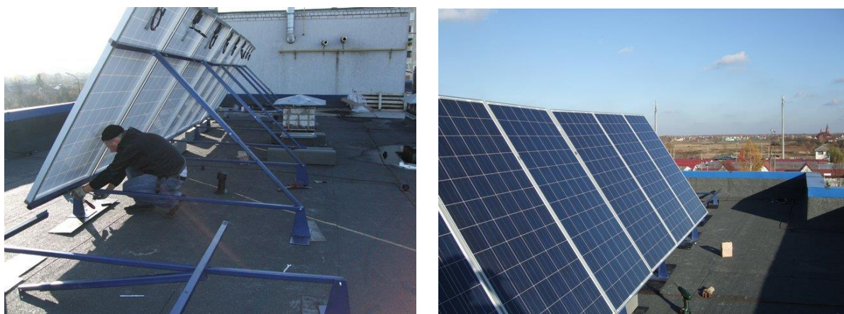
Рисунок 3.2 – Установка по производству электрической энергии из возобновляемых источников энергии (солнце) мощностью 10 кВт по адресу: г. Брест, ул. Луцкая
