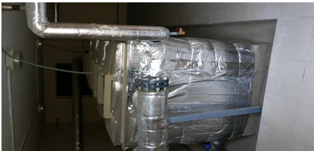
Рисунок 10 Фотография системы утилизации тепловой энергии сточных вод
