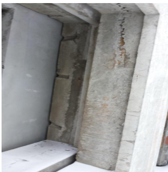
Рисунок 16 Бетонные перемычки, образованные при формовании изделий
