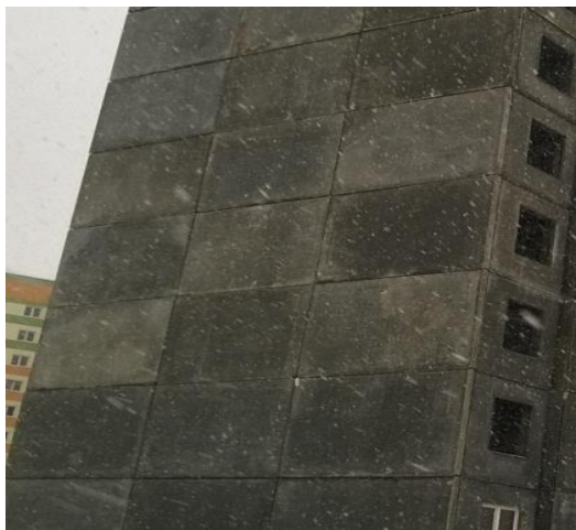
Рисунок 15 Фотография фрагмента стены здания в г. Могилеве
