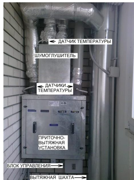
Рисунок 10 Фотография вентиляционной установки на лоджии
